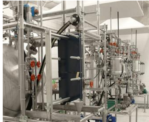
Impianto di idrolisi enzimatica
